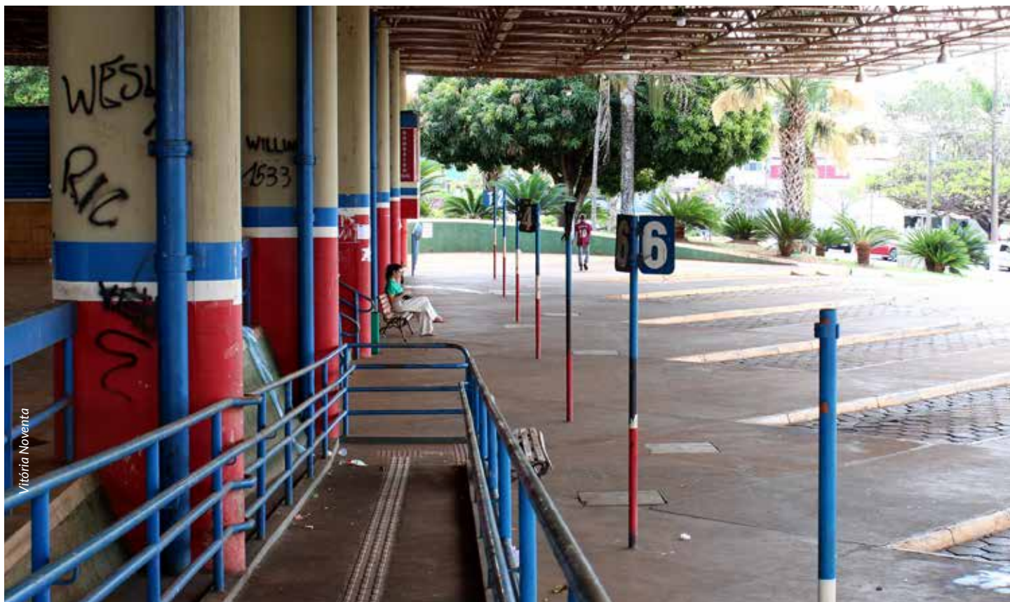
Terminal Rodoviário de Batatais está sem manutenção adequada e causa medo nos usuários
